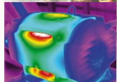
Temperatura irregular anómala del motor
